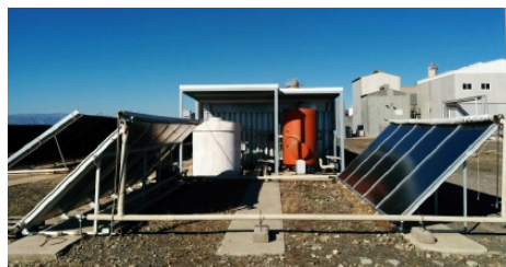
Figura 1. Instalación piloto de la PSA.
