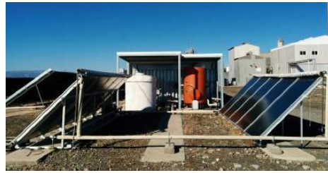
Figura 1. Instalación piloto de la PSA.
