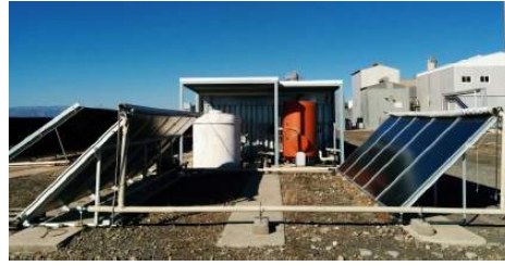
Figura 1. Instalación piloto de la PSA.
